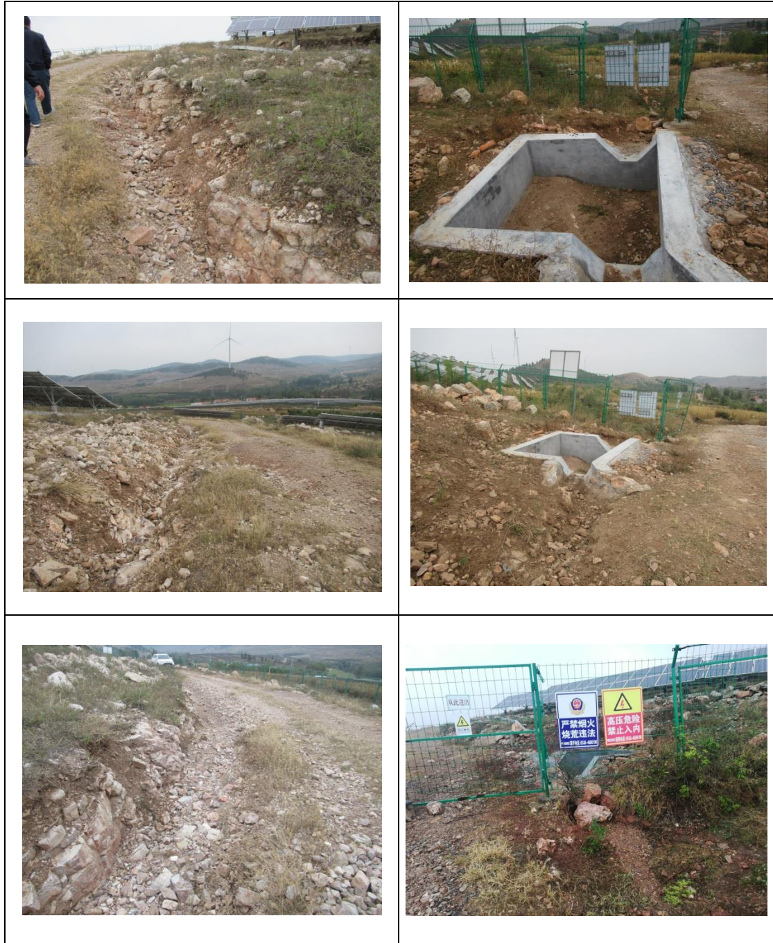
光伏发电区排水沟、沉砂池
